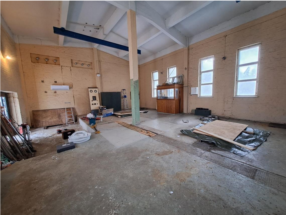
Kuva 1. Turbiinisalin lattian ja seinien maaleista, sekä tasoitteista otetut näytteet eivät sisällä asbestia (näytteet 1 ja 2). Näytettä 1 vastaavat materiaalit voidaan PCB ja RM pitoisuuksien osalta poistaa ja hävittää normaalisti. Näytteen 2 raskasmetallipitoisuuksissa havaittiin vaarallisen jätteen ylittäviä pitoisuuksia.
