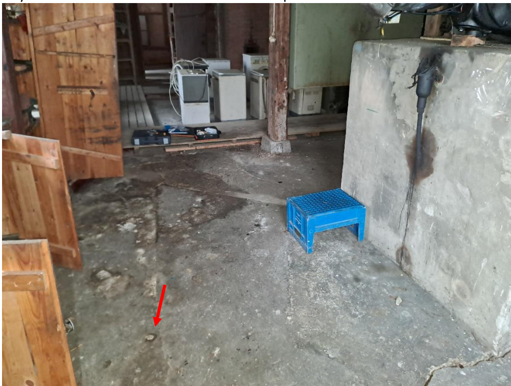
Kuva 8. Meijerin mustasta lattiatasoitteesta otettu näyte ei sisällä asbestia (näyte 8). Näytettä 8 vastaavat materiaalit voidaan PAH-pitoisuuden osalta käsitellä normaalisti.
