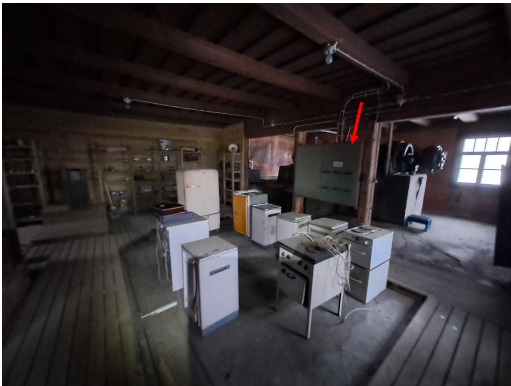
Kuva 11. Vanhojen sähkökeskusten sisällä voi olla asbestipitoisia kuitusementtilevyjä (sähkökeskuksia ei ole avattu/purettu). Sähköpääkeskukset ja vanhat sähkövedot voivat sisältää muita haitallisia aineita sisältäviä komponentteja/materiaaleja, kuten lyijyä.
