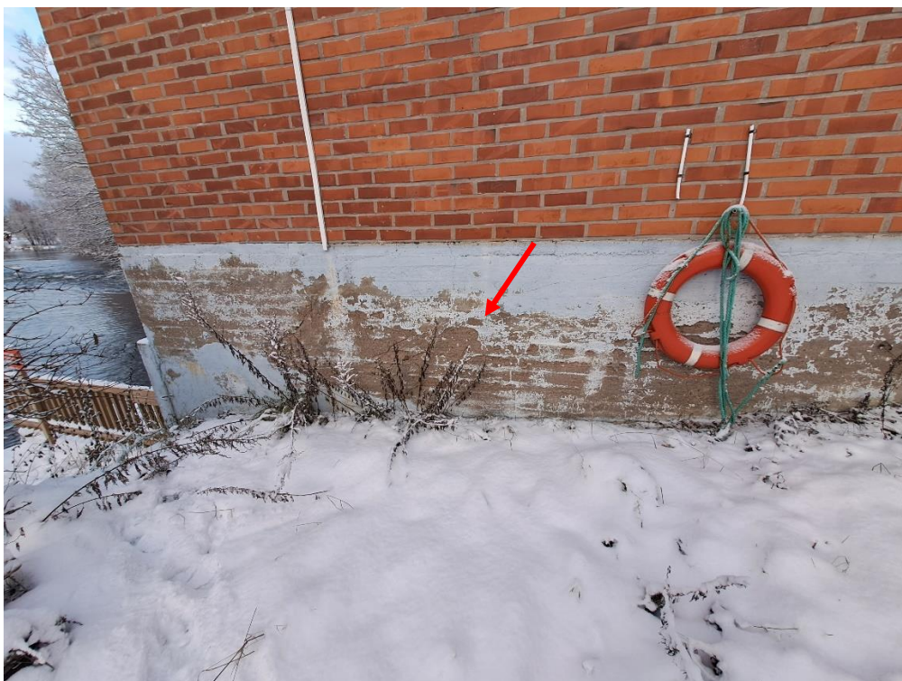
Kuva 5. Voimalaitoksen sokkelimaalista otetun näytteen raskasmetallipitoisuuksissa havaittiin vaarallisen jätteen ylittäviä pitoisuuksia (näyte 5). Näytettä 5 vastaavat materiaalit tulee käsitellä vaarallisena jätteenä.
