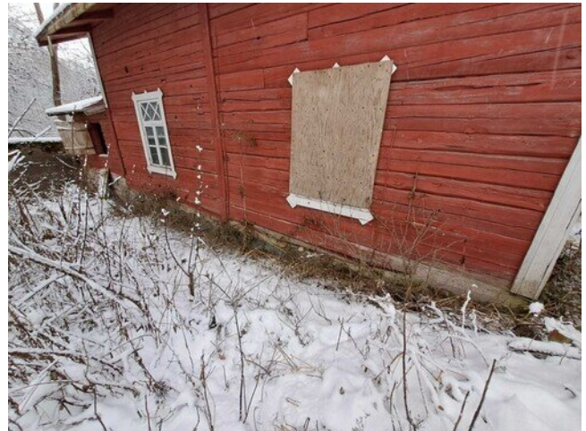
Kuva 18 Yläjuoksun puoleisessa päädyssä lahovaurioita on havaittavissa kahdessa alimmassa hirsivarvissa.
