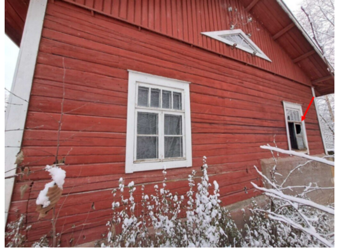
Kuva 28 Rakennuksen ikkunat ovat puurakenteisia 1-2 lasisia ikkunoita. Osa ikkunälaseista on rikkoutunut.
