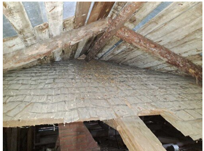
Kuva 32 Osassa rakennusta peltikatteen alla on vanha pärekatto.
