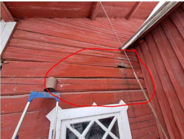
Kuva 13 Räystäään kohdalla lahovauriot yltävät hirren läpiasti.
