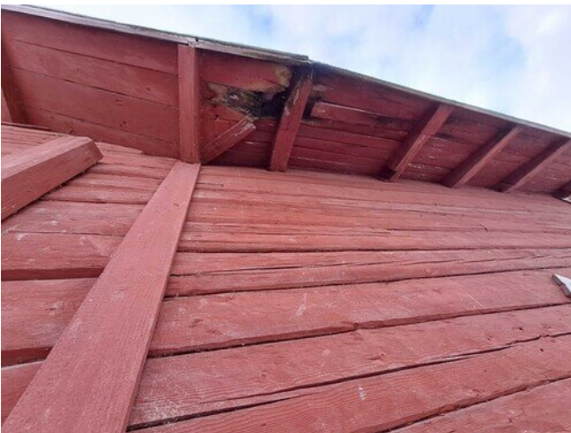
Kuva 39 Vesikaton räystäsrakenteissa on havaittavissa paikoin lahovaurioita.
