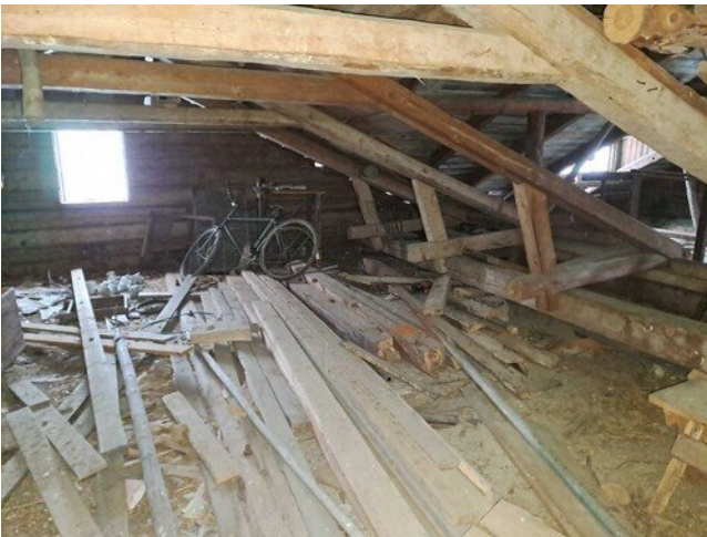
Kuva 35 Yläpohjan puurakenteissa ei havaittu merkittäviä lahovaurioita. Yläpohjan eristeenä on purua, hiekkaa ja sammalta.
