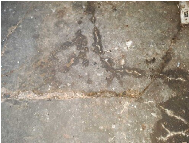
Kuva 9 Maanvaraisessa betonilaatassa on havaittavissa laajoja halkeamia.
