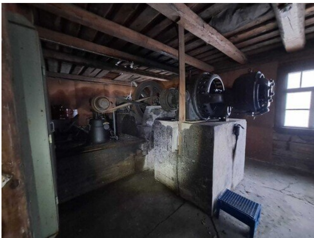
Kuva 45 Kuva sähkögeneraattorin tilasta. Sähkögeneraattorin tilan lattia, seinien ja laipion pintamateriaalit ovat vaurioituneet laitteistosta vuotaneesta öljystä.
