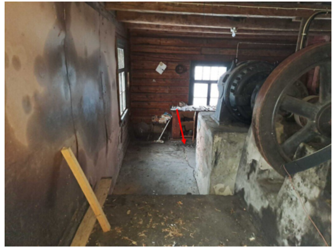
Kuva 10 Maanvaraisessa betonilaatassa on havaittavissa laajoja halkeamia.
