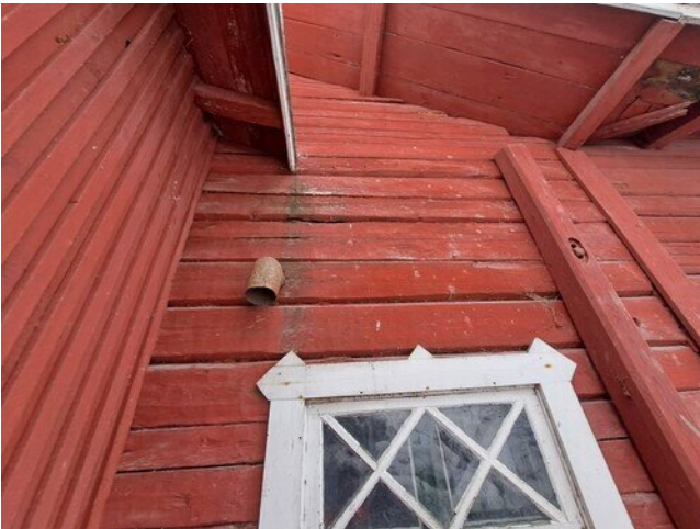
Kuva 17 Räystäään kohdalla lahovauriot yltävät hirren läpiasti.
