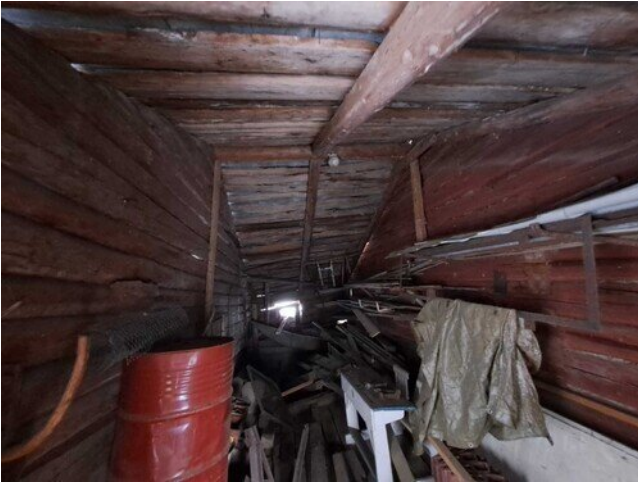
Kuva 47 Kuva kosken puolella sijaitsevasta laajennusosasta, joka on romahtanut.
