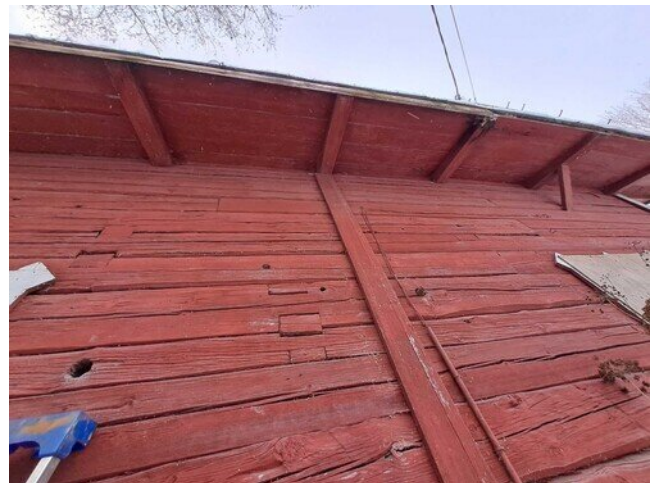
Kuva 40 Vesikaton räystäsrakenteissa on havaittavissa paikoin lahovaurioita.
