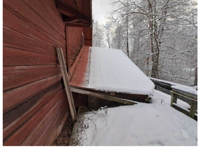
Kuva 20 Kuva kosken puolella sijaitsevasta laajennusosasta, joka on romahtanut.
