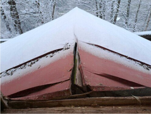
Kuva 37 Rakennuksen koskenpuolalla sijaitsevan romahtaneen laajennusosan kattorakennetta.
