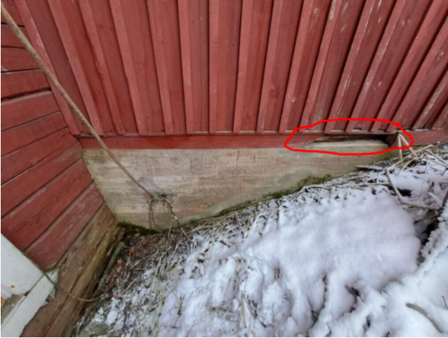
Kuva 15 Kuvan osoittamalla kohdalla lahovaurioita sisäänkäynnin puurungon alajuoksussa.
