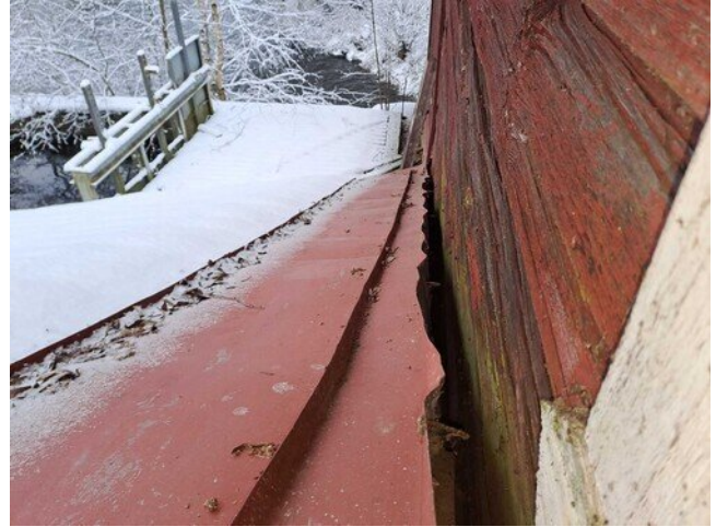
Kuva 38 Rakennuksen koskenpuolalla sijaitsevan romahtaneen laajennusosan kattorakennetta.
