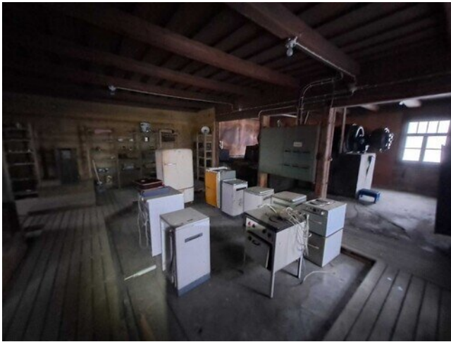
Kuva 43 Kuva aulatilasta. Aulan seinien ja laipion hirsijä puupinnat ovat pääosin puhtaalla puupinnalla ja ovat kohtalaisessa kunnossa.
