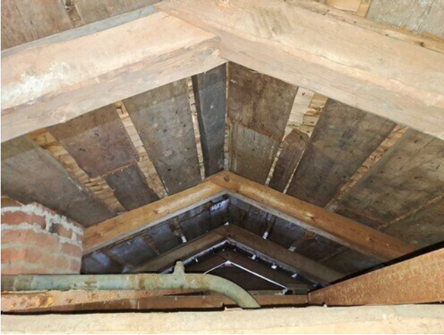
Kuva 33 Osassa rakennusta peltikatteen alla on vanha pärekatto.
