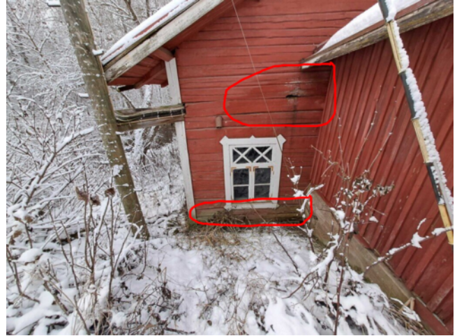
Kuva 12 Sisäänkäynnin vasemmalla puolella havaittiin lahovaurioita kuvan osoittamilla kohdilla.
