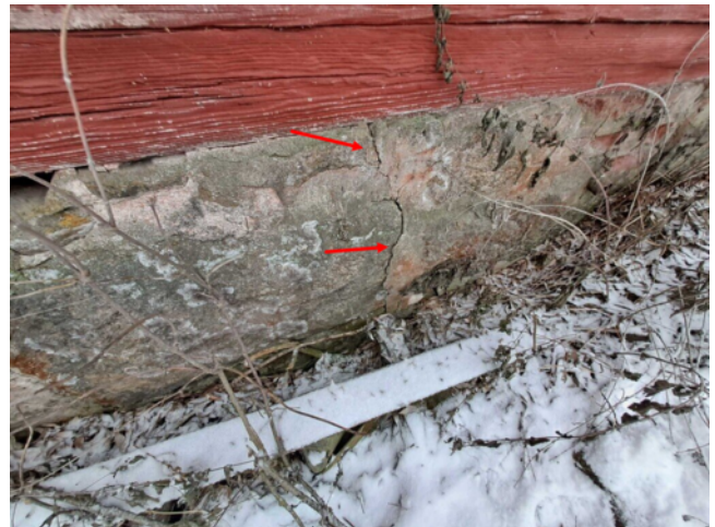
Kuva 2 Yläjuoksun puoleisen päädyn sokkelirakenne on luonnonkivijalkaa / betonia. Sokkelirakenteessa on havaittavissa paikoin halkeamia.
