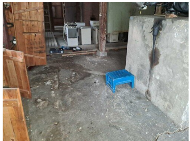
Kuva 8 Maanvaraisessa betonilaatassa on havaittavissa laajoja halkeamia.
