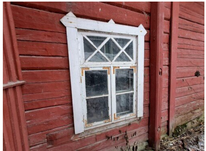
Kuva 30 Ikkunoiden puuosissa ei havaittu merkittäviä vaurioita ja ne ovat ikäänsä nähden kohtalaisessa kunnossa.
