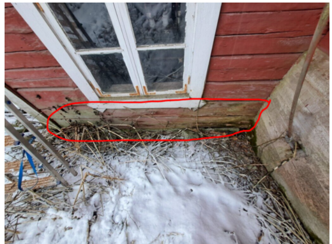
Kuva 14 Alimmissa hirsivarveissa lahovauriot yltävät noin 50 mm syvyyteen.
