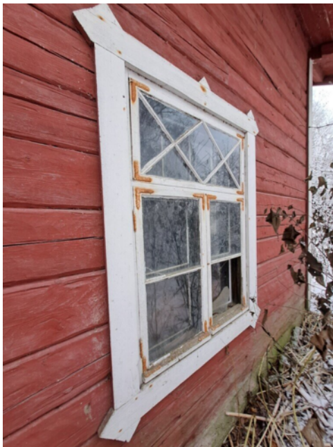
Kuva 29 Osa ikkunälaseista on rikkoutunut ja ikkunoiden saranoissa ja metallivahvikkeissa on havaittavissa ruostevaurioita.
