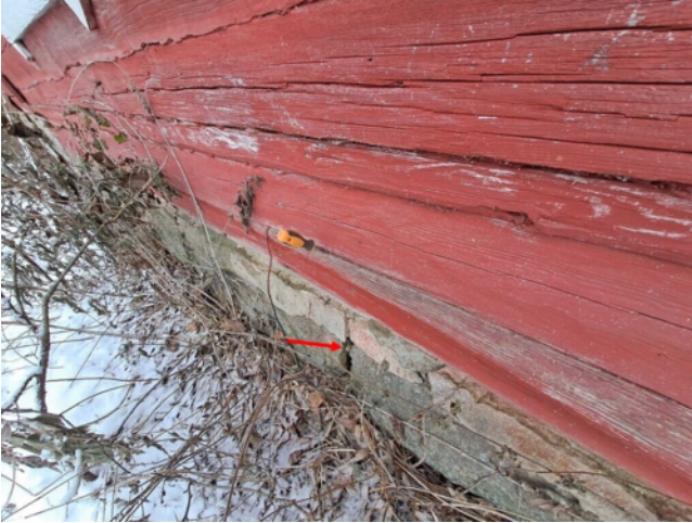
Kuva 3 Sokkelirakenteessa on havaittavissa paikoin halkeamia.
