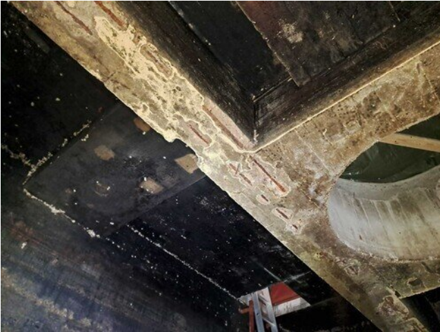
Kuva 13 Välipohjan betonipalkeissa on havaittavissa runsaasti ruostuneita raudoituksia, joka johtuu vähäisestä suojabetonin osuudesta.
