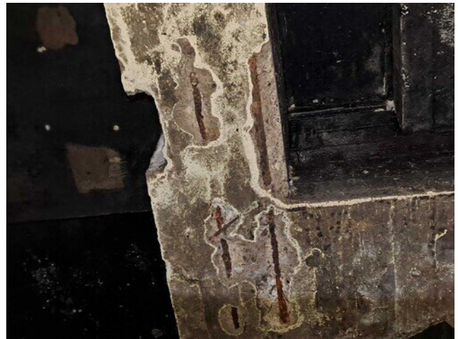
Kuva 12 Välipohjan betonipalkeissa on havaittavissa runsaasti ruostuneita raudoituksia, joka johtuu vähäisestä suojabetonin osuudesta.
