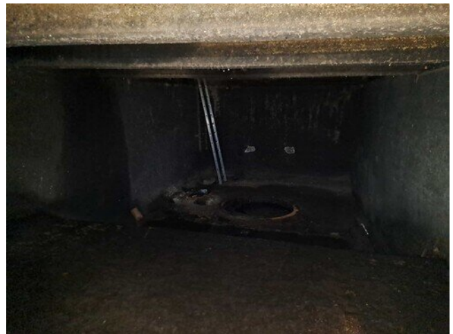
Kuva 8 Kuva turbiinikammioista. Turbiinikammion lattian (alapohjan) betonilaatta on päällisin puolin kohtalaisessa kunnossa. Turbiinikammioiden alapohjarakenne on suositeltavaa tutkia tarkemmin kun pato on purettu pois ja kammioihin ei pääse enää valumaan vettä.
