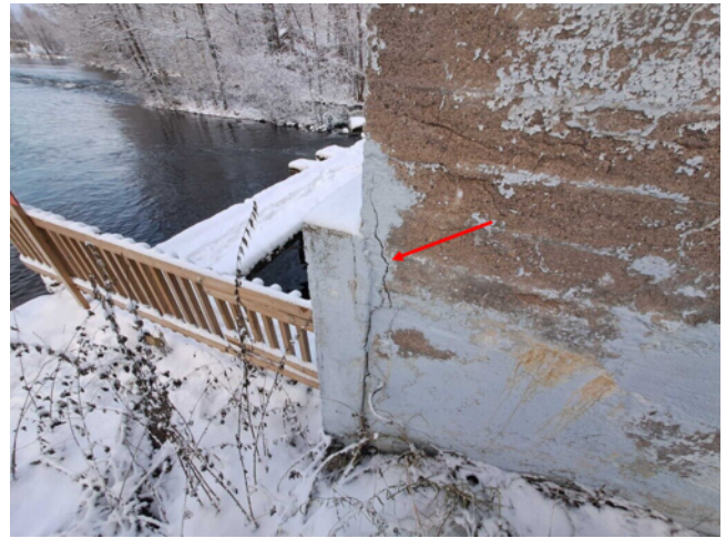
Kuva 4 Sokkelirakenteessa on havaittavissa yksittäisiä syvempiä halkeamia.
