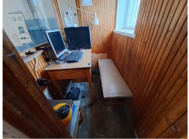
Kuva 30 Kuva turbiinisalin valvontakopista.
