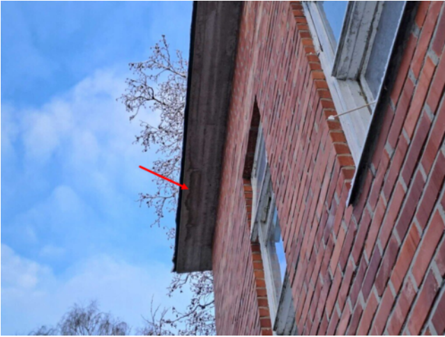
Kuva 28 Rakennuksen räystäärakenteissa on paikoin havaittavissa kosteuden aiheuttamia jälkiä, kuten antennijohtojen läpiviennin kohdalla, sekä alajuoksun puoleisella räystäällä.
