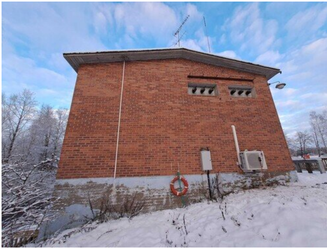
Kuva 3 Kuva ilmalämpöpumpun puoleisesta julkisivusta. Sokkelin maalipinnoite on kulunut pois lähes kauttaaltaan. Kyseisiltä alueilta betoni on alkanut rapautumaan / halkeilemaan.
