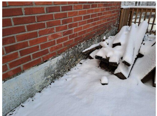
Kuva 6 Yläjuoksun puoleisella sivulla sokkelirakenteessa on havaittavissa sammalta.
