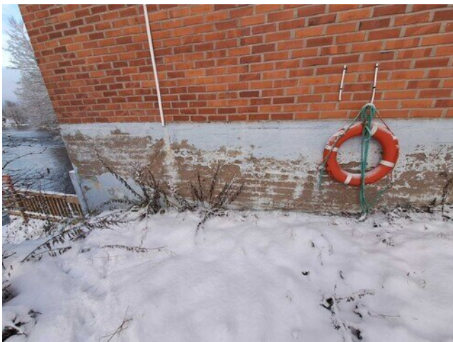
Kuva 5 Sokkelissa on havaittavissa runsaasti maalipinnoitteen kulumista ja betonin rapautumista.
