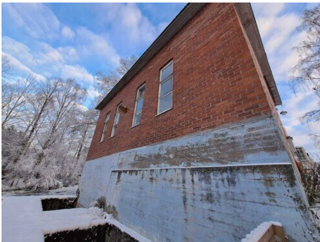
Kuva 1 Kuva alajuoksun puoleisesta julkisivusta. Sokkelin maalipinnoite on osittain kulunut pois. Kyseisiltä alueilta betoni on alkanut rapautumaan / halkeilemaan.
