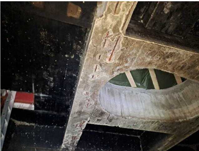
Kuva 11 Välipohjan betonipalkeissa on havaittavissa runsaasti ruostuneita raudoituksia, joka johtuu vähäisestä suojabetonin osuudesta.
