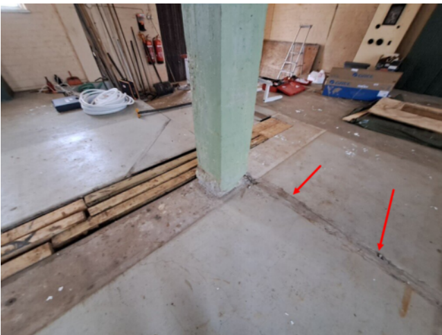
Kuva 31 Lattiassa on havaittavissa paikoin halkeamia.
