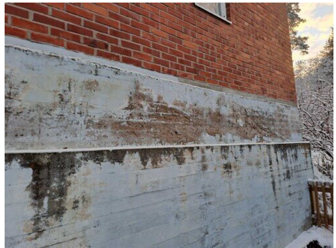
Kuva 2 Sokkelin maalipinnoite on osittain kulunut pois. Kyseisiltä alueilta betoni on alkanut rapautumaan / halkeilemaan.
